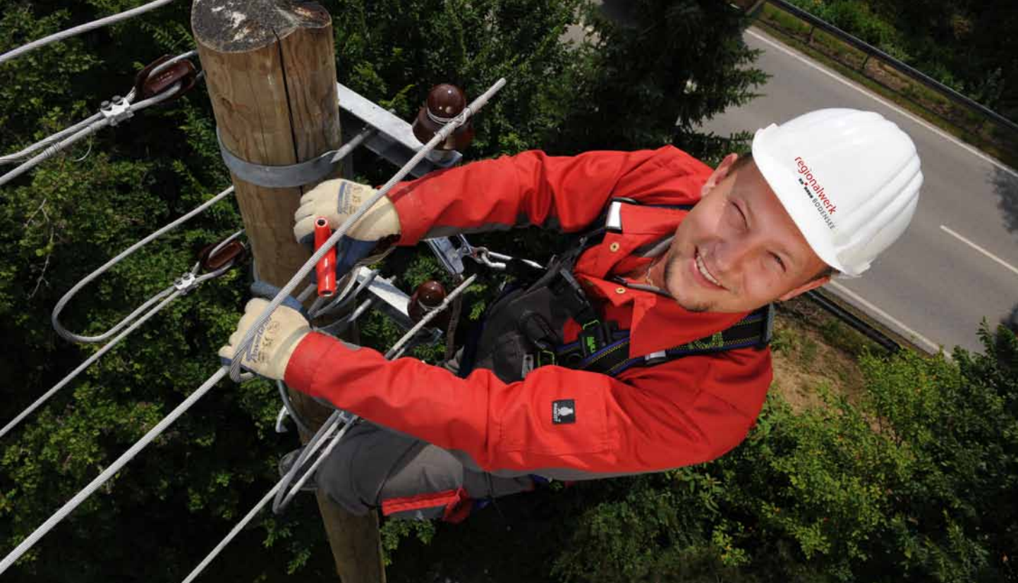
Garantiert schwindelfrei: Patrick Keller am Freileitungsmasten.
